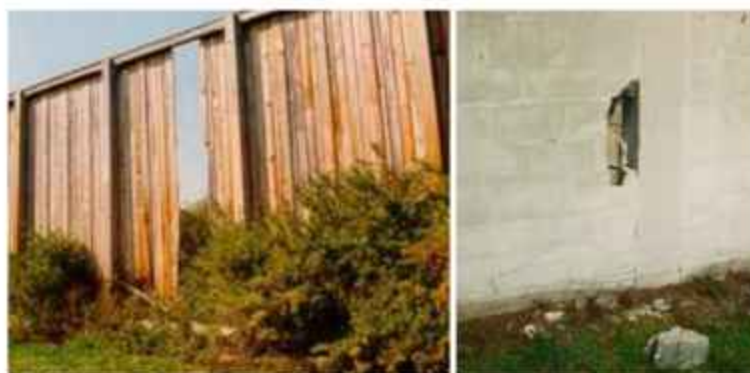
Слика 5.4. Примери оштећења на баријерама [25]
