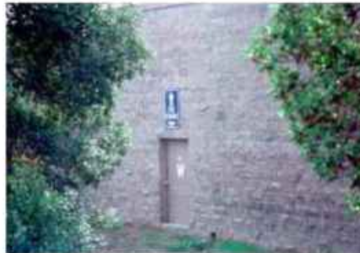
Слика 5.13. Пожарна сигурност: пожарна врата [25]
